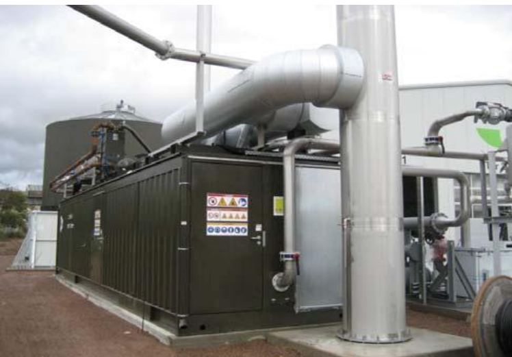
Digesteur et centrale de cogénération
