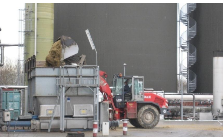
Fosse de réception et digesteur
