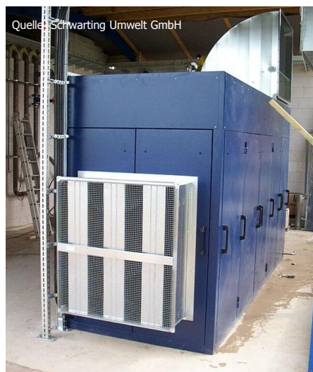
Centrale de cogénération
