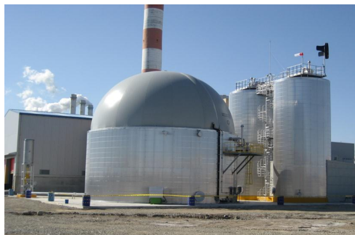
Usine de biogaz
