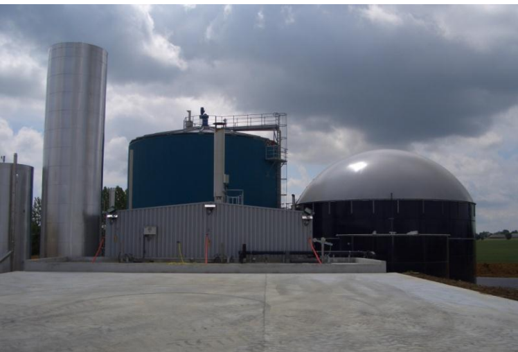
Usine de biogaz
