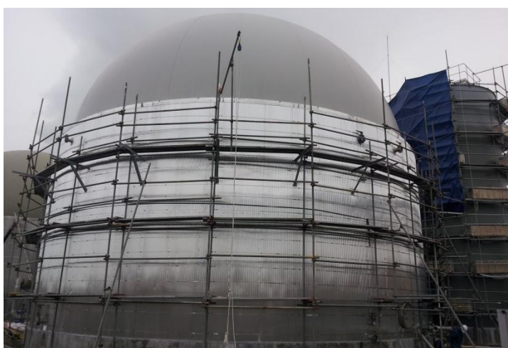
Usine de biogaz
