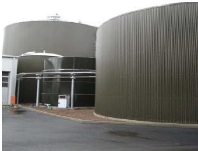
Digesteur et traitement des eaux usées
