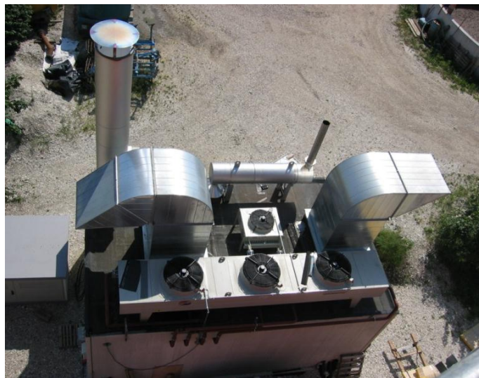
Centrale de cogénération
