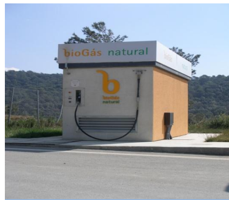
Poste de stockage et Remplissage
