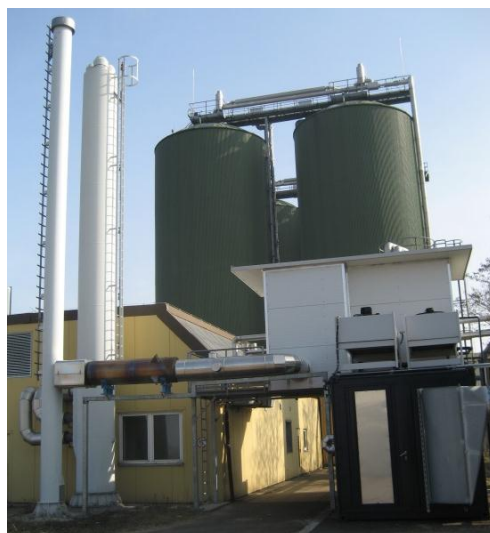
Centrale de co-génération
