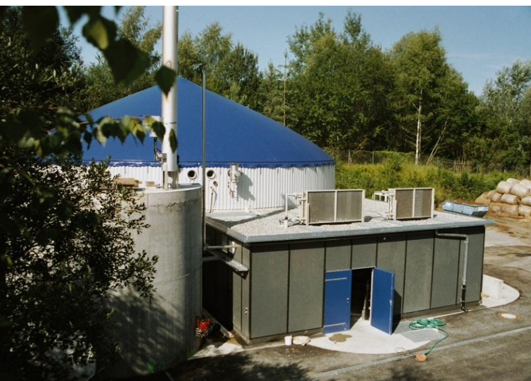
Digesteur, halle aux machines
