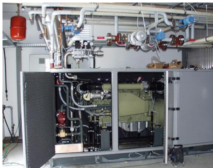
centrale de cogénération
