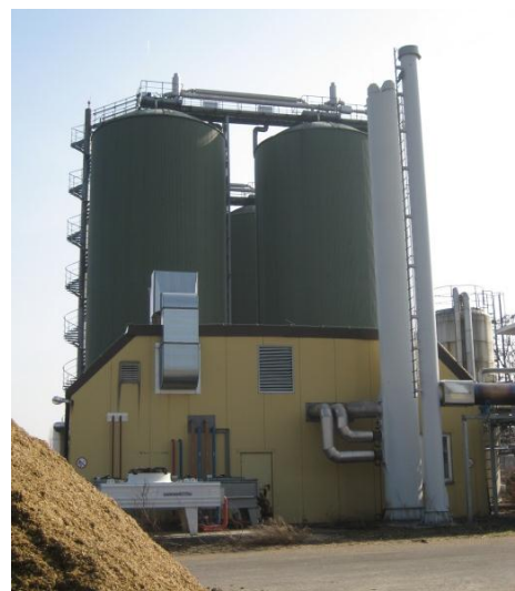
Usine de biogaz
