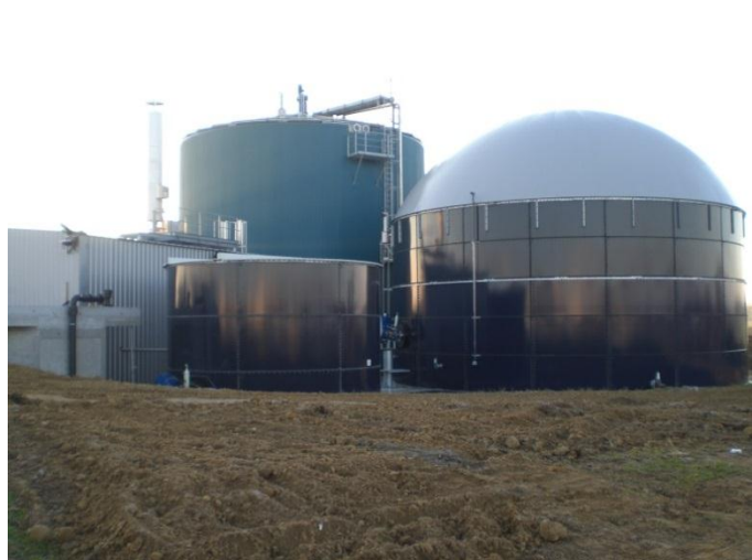
Digesteur et post-digesteur
