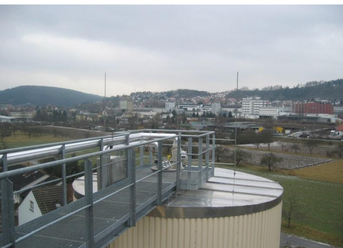
Toît du digesteur de haute performance
