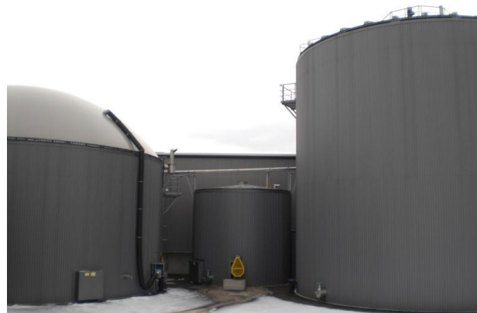
Post-digester et digesteur
