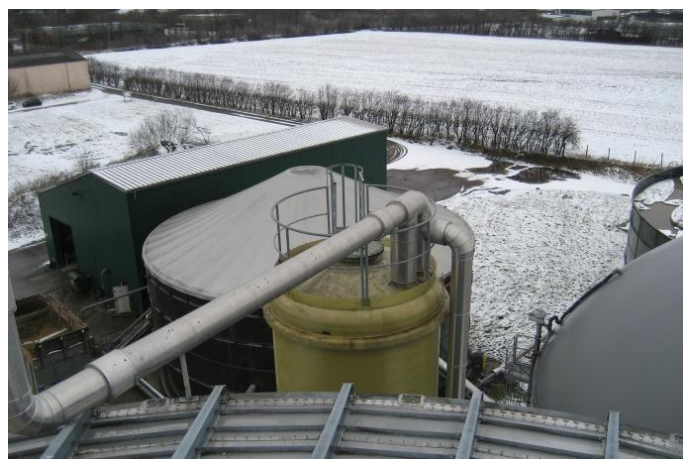
Hydrolyse, désulfuration, post-digesteur
