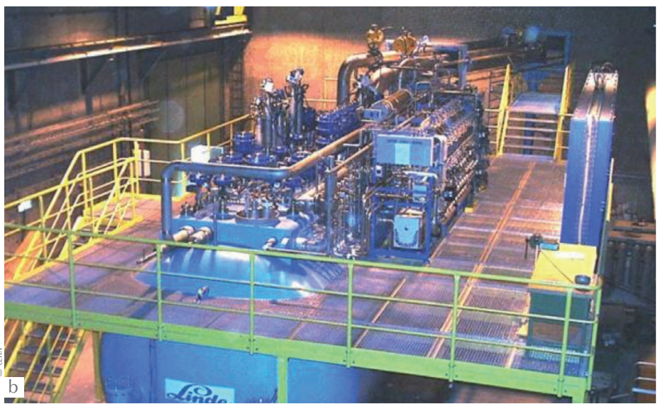
6. Réfrigérateurs 18 kW à 4,5 K (Air Liquide et Linde) alimentant (a) les cavités accélératrices hyperfréquence du LEP et (b) les aimants supraconducteurs du LHC dans les années 1990-2010.
