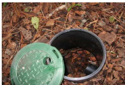
Regard d'irrigation (photo : Greywater Action)
