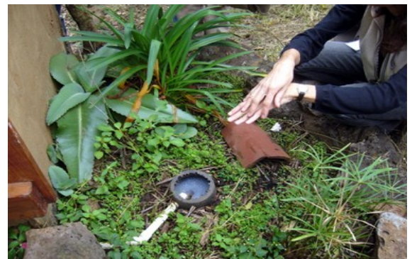
Pédo-épuration pour un évier de bureau au Mexique (photo : Didier Bourrut Lacouture)
